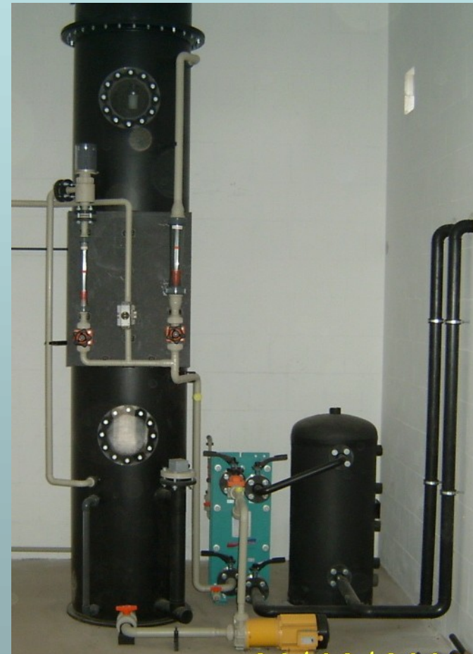
Depuración externa del gas
