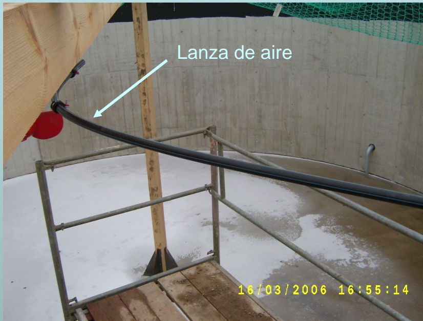
Desulfurización del aire en el almacenamiento de gas
